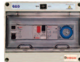
1 BOMBA TRIFÁSICA A 400 V
